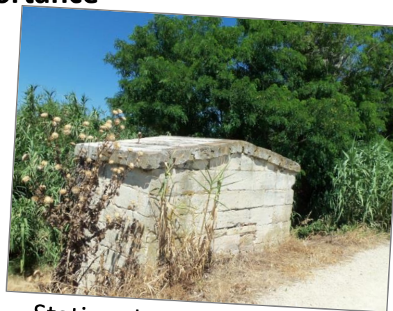
Station de pompage (Mas de Vert)
