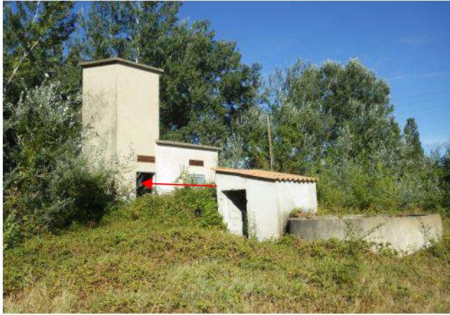
Photographie 15 : Entrée du transformateur avec présence de guano © Fanny Albalat (GCP), 2022
