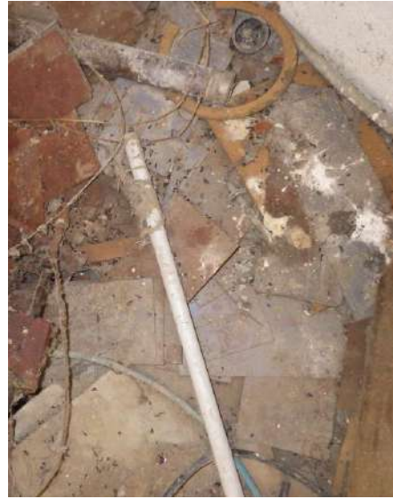
Photographie 16 : Guano dans le transformateur © Fanny Albalat (GCP), 2022
