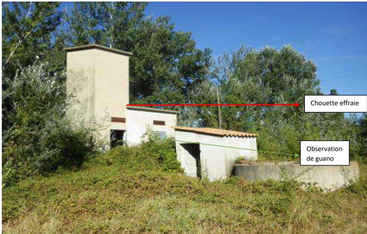
Photographie 17 : Localisation des Chiroptères et de la chouette effraie dans le transformateur électrique © Fanny Albalat (GCP), 2022
