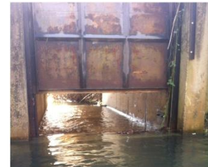
Figure 31 : Ecoulement de l'exutoire de la lône vers les lacs (04/12/2018). ©Cesame
