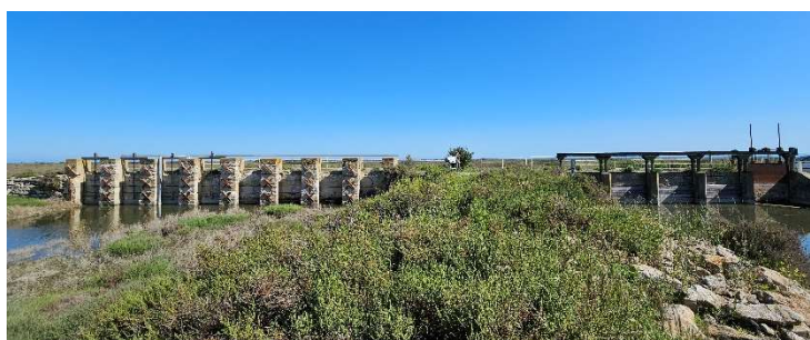
Figure 1 : Photographie du pertuis de la Comtesse (à gauche) et des martellières à l'arrivée du Versadou (à droite)
