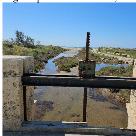
Figure 2 : Pertuis de Rousty comblé par des dynamiques sédimentaires
